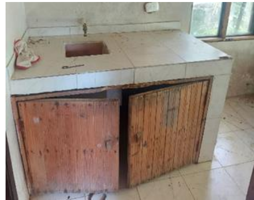
Fotografía 2. Estado actual del mobiliario interno del Punto de Información
