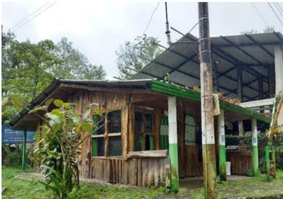
Fotografía 1. Punto de información de Aguas y Aguas de Pereira en condiciones de abandono (Cuenca Alta del Río Otún)
